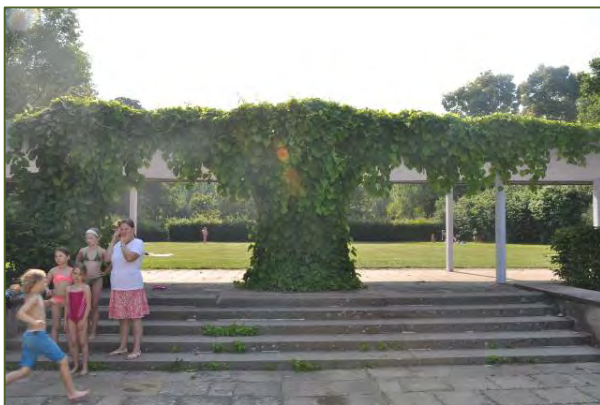
Abb. 191 Dachschäden an der Pergola, 2016
