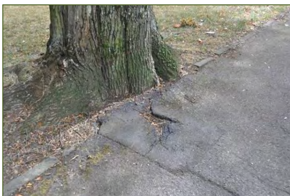
Abb. 39 Schadhafter Asphaltbelag am Wurzelhals, 2016
