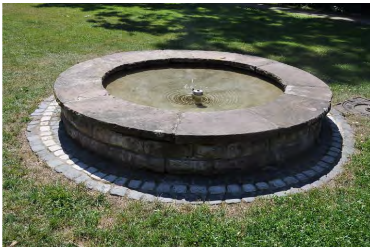
Abb. 232 Schadhafte Mauerabdeckplatten im Immergrünen Garten 2015
